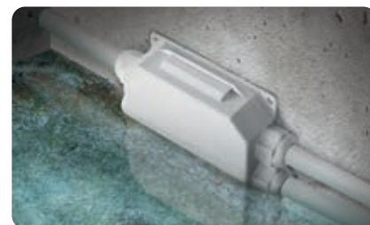
Instalação com prensa cabo.
